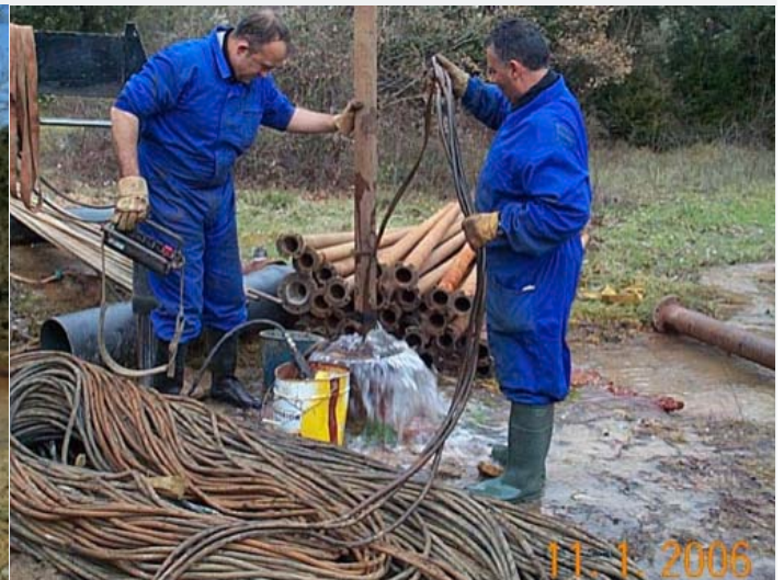
Equipamiento del sondeo Angosto para ensayo de bombeo
