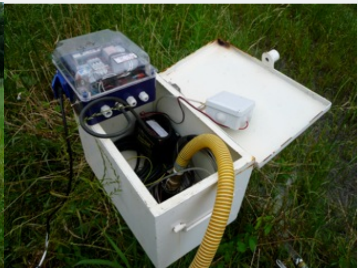
Equipamiento de medición automática de nivel y equipo de bombeo en el Sondeo Hernani -C
