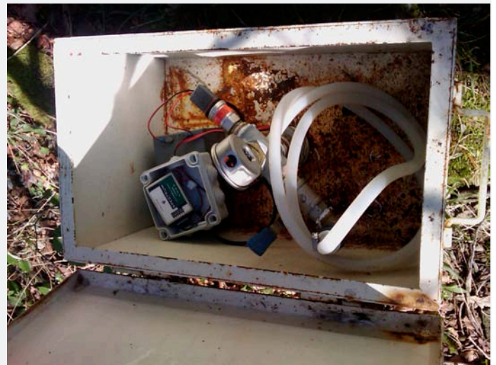
Equipamiento de medición automática de nivel en el sondeo Legorreta-5
