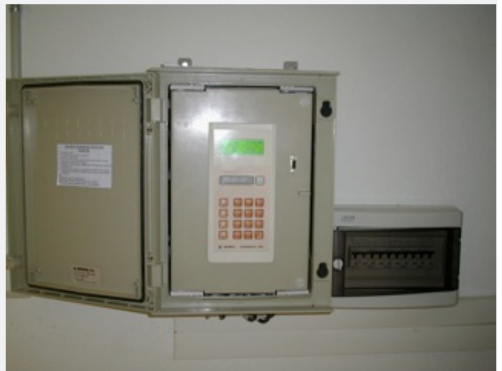
Equipamiento medición automática del nivel en el sondeo Gallandas 1.
