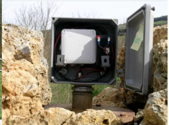
Equipamiento medición automática del nivel.
