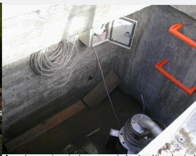
Arqueta y equipamiento para control automático de nivel.
