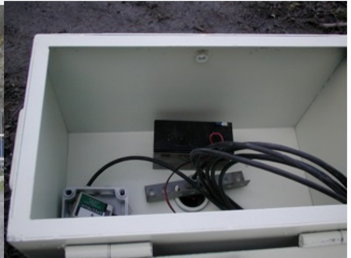
Equipo de control piezométrico automático en Aguas Frías
